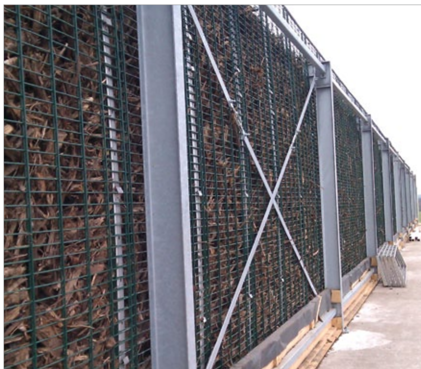
Abb. 1: Zweistufige Abluftreinigungsanlage mit Biowurzelholz
